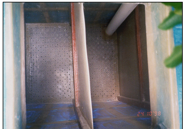
Konstruksi bagian dalam bak rekator pengolahan lanjut.
