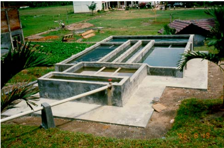
Foto 5.14 : Unit pengolahan air bersih dengan saringan pasir lambat “Up Flow”, Kapasitas 100 M 3 /hari. Lokasi : Pondok Pesantren La Tansa, Lebak, Banten.
